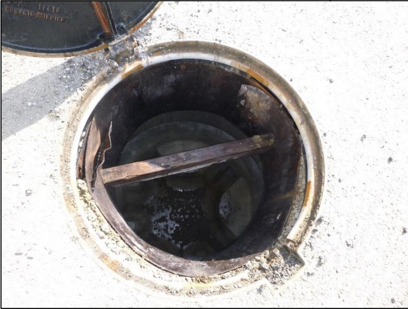
Photo 6 : Planches de coffrage à retirer – Impasse de Fromy
