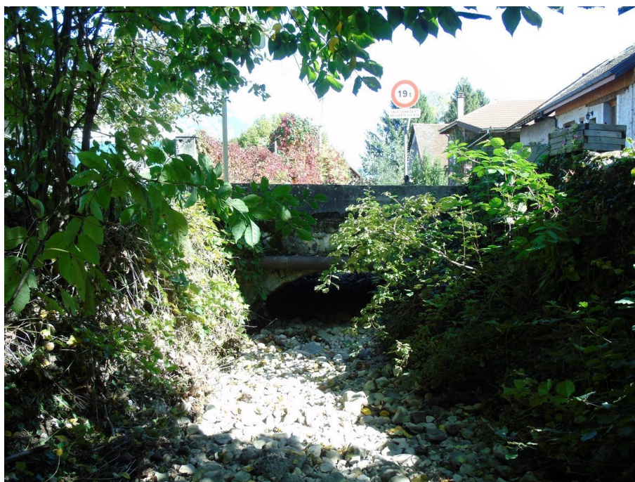
Figure 8: Le pont de Clessant (RD22) vu de l'amont. L'ouvrage est susceptible de perturber les écoulements et de favoriser des dépôts en amont.
