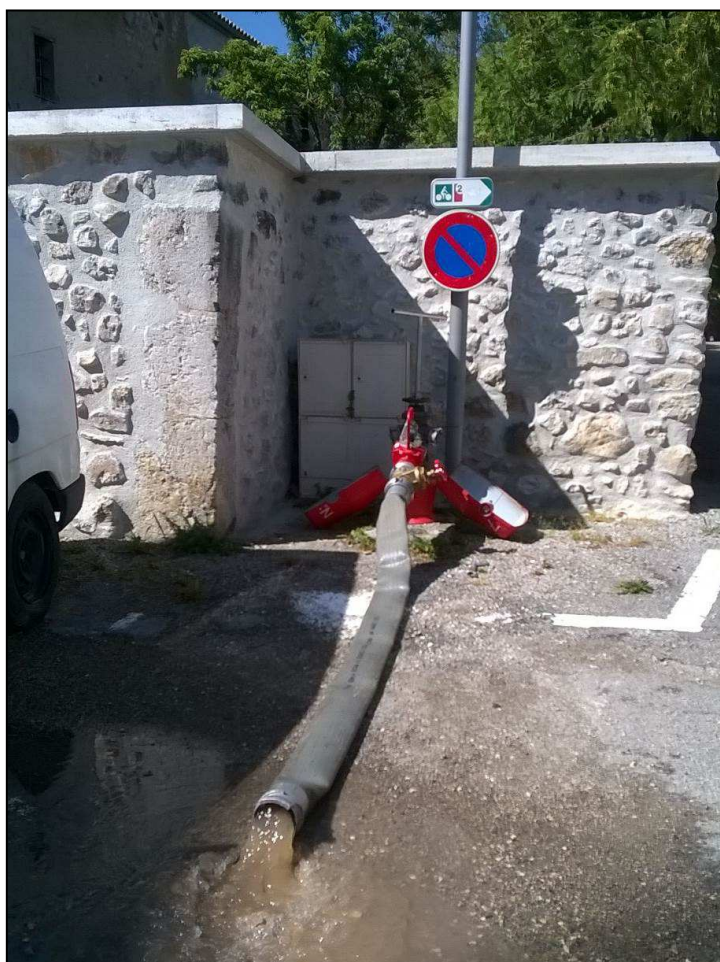
Mesure du poteau incendie n°07
