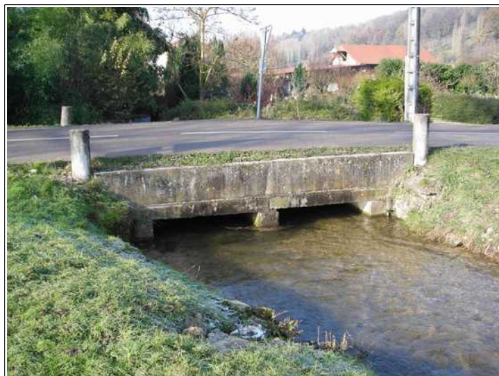
Vue du pont de la RD54f, on notera sa faible ouverture. En débordant, le ruisseau peut se diriger en direction des constructions visibles en arrière plan sur sa rive droite.
