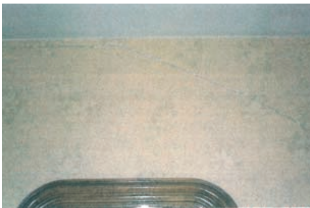
Fissuration intérieure, tapisserie déchirée - Maison André.
