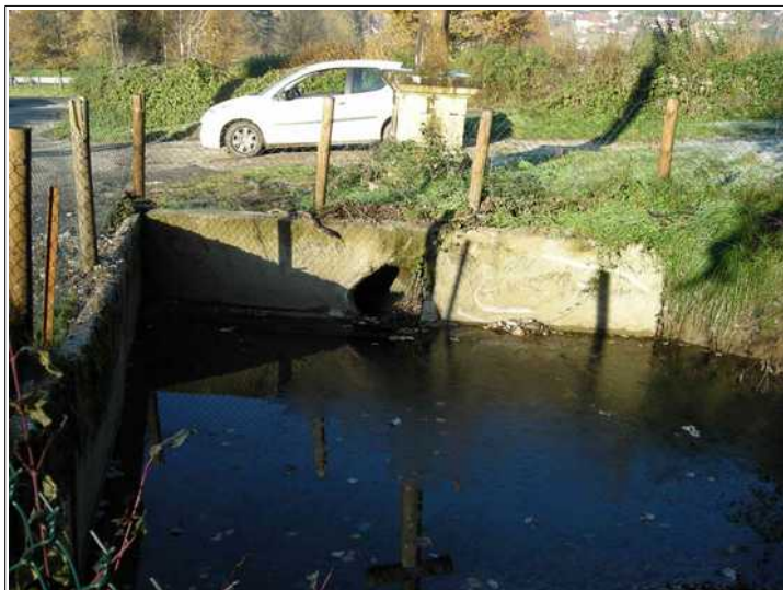
Piège à matériaux de la combe de DEMPTÉZIEU.
