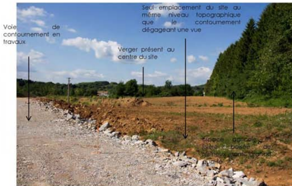
Vue du site depuis la voie de contournement en limite du bosquet sud du site
