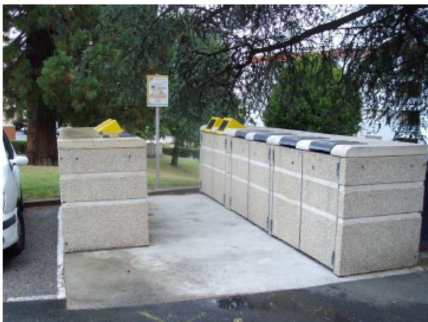
Abri préfabriqué + dalle + panneau de consignes
