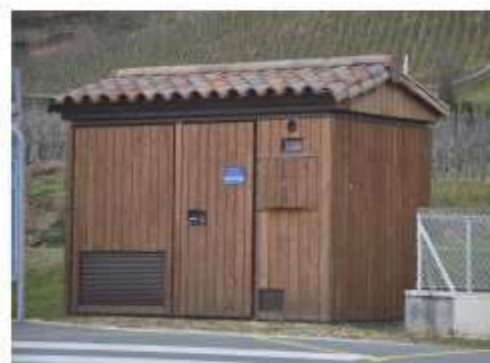
Exemple de local pour transformateur électrique
