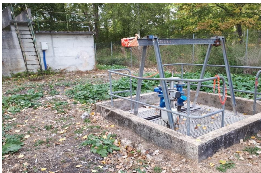
Figure 7 : Poste de relevage du Stade
