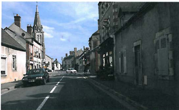
Le revêtement des trottoirs est dégradé
