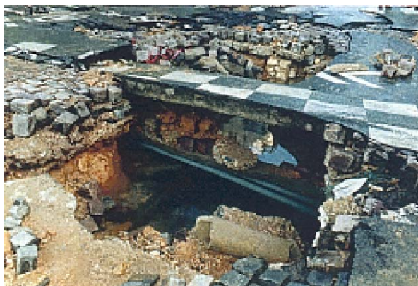
Effondrement d'une cavité souterraine
