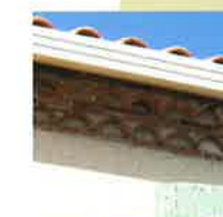
Utiliser du PVC pour les gouttières ou tuyaux de descente : ce matériau, d'une durée de vie limitée et peu valorisant pour le savoir-faire artisan, est du plus mauvais effet sur le bâti ancien.
