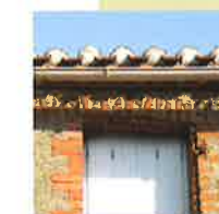
La gouttière demi-ronde (ici en PVC) vient cacher la génoise et crée une ombre projetée sur le mur. Même remarque concernant les gouttières rectangulaires totalement inappropriées.
