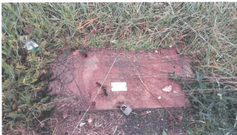
Figure 1 : Verrouillage de l'accès à la cuve enterrée
