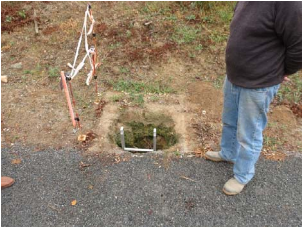
Photo 3 : Effondrement encore visible à la Guénaudière
