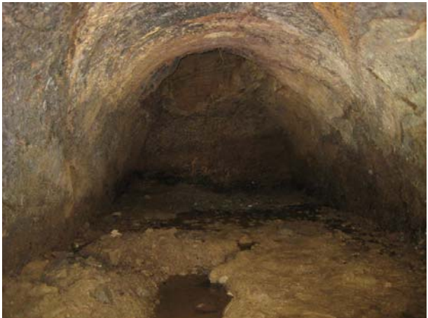
Photo 3 : Chutes de blocs dans la grotte de Moulinard
