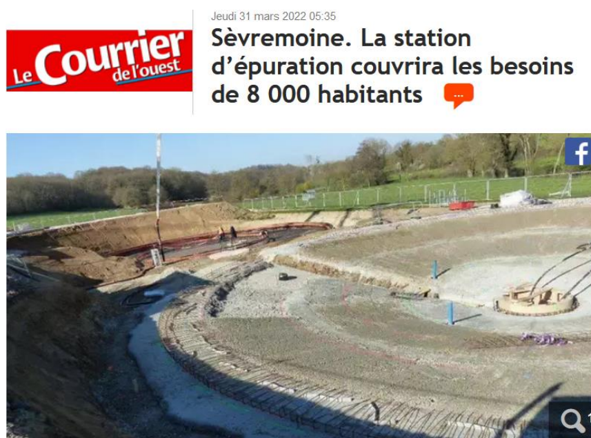
Vue d'ensemble du terrassement de la station d'épuration où seront traitées les eaux usées.
