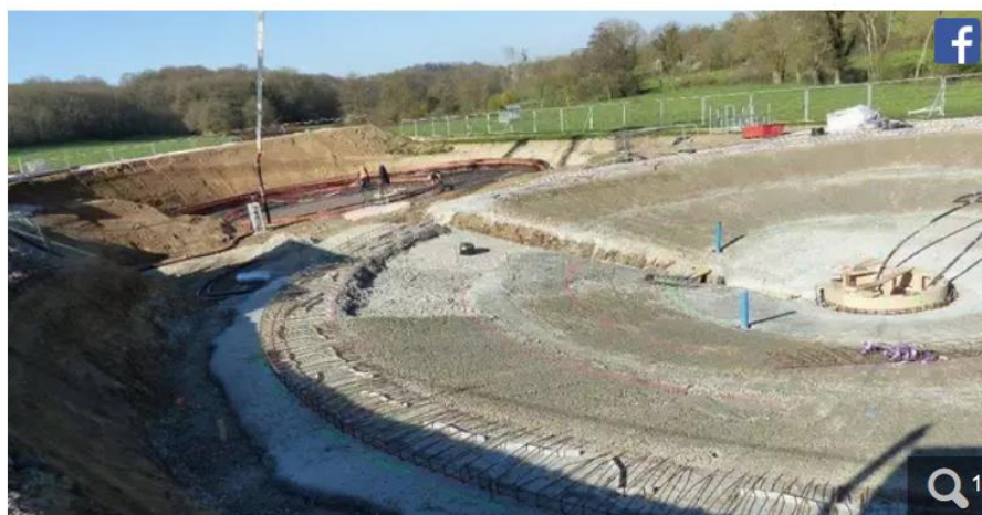
Vue d'ensemble du terrassement de la station d'épuration où seront traitées les eaux usées.
