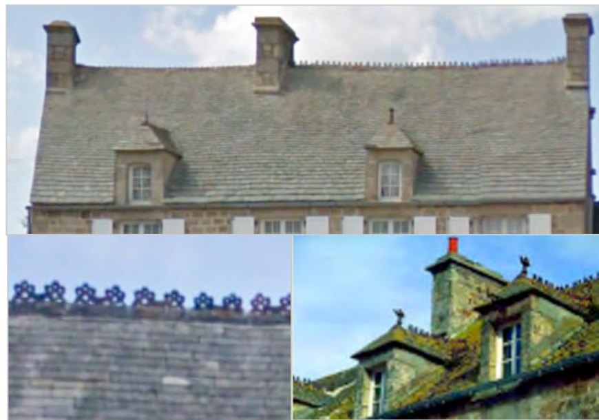
Exemple de toit en schiste (en haut), de « taffaïtes » (à gauche) et de « gaudions » situés au bout des lucarnes (à droite).
