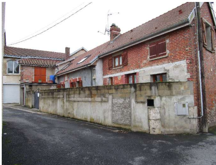
Figure 97 : murs en parpaing laissés à nu dans le bourg
