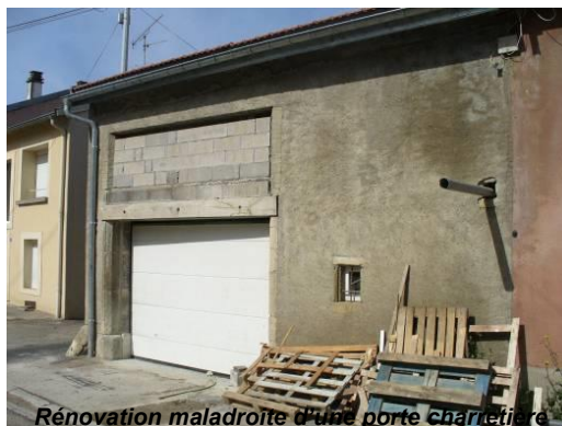
Rénovation maladroite d'une porte charretière
