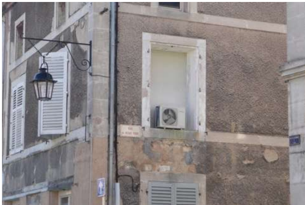
Equipement de piètre qualité, rue du Vieux Four
