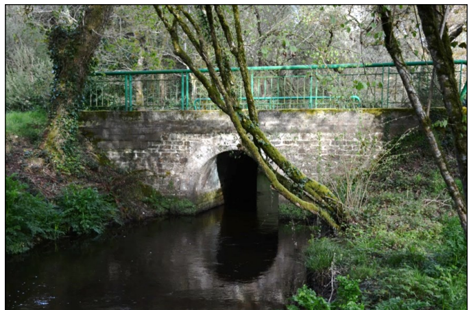
Pont provoquant une rupture de berge, Moulin de Kerollin, Lanvaudan Source : Lorient Agglomération, 2016
