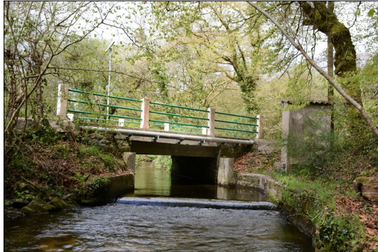
Seuil et rupture de continuité des berges, Pont er Garrec, Lanvaudan Source : Lorient Agglomération, 2016
