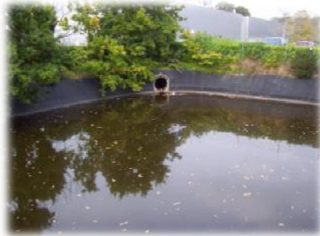
Photo 20 : bassin connecté au réseau pluviale du centre commercial de Kerfontaine
