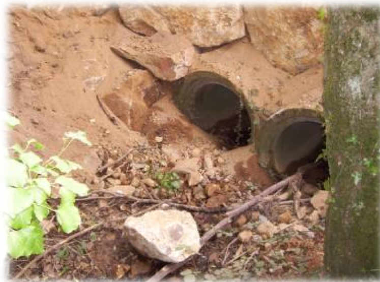
Photo 5 : buses mal placées, elles risquent de se boucher au moindre épisode orageux (près du bourg)
