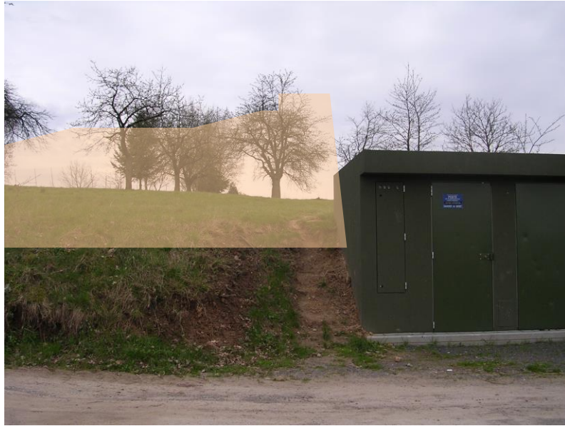
Aperçu partiel de l'E.R n°2 à proximité du poste électrique.
