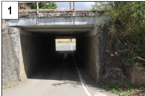
1 Passage inférieur à l'entrée Ouest du village. Sa taille réduite ne permet pas le passage à double sens. Une piste cyclable est identifiée.
