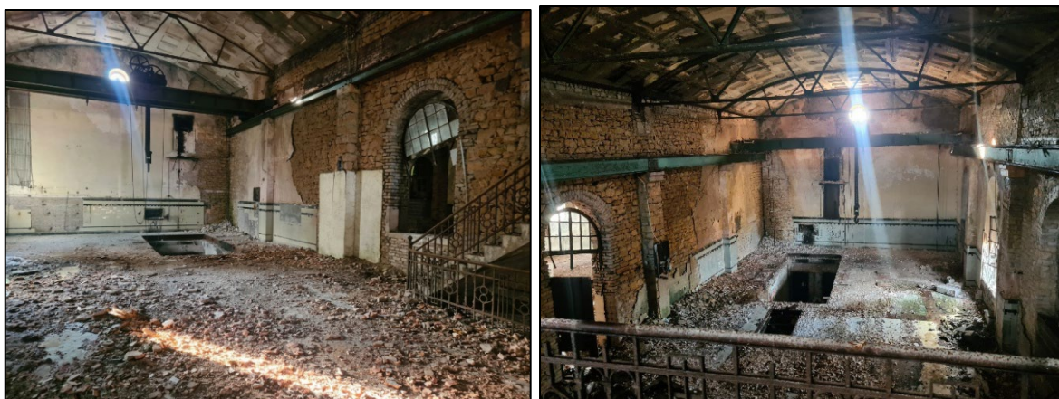
Vues de l'intérieur du bâtiment d'extraction en état de dégradation avancée.
