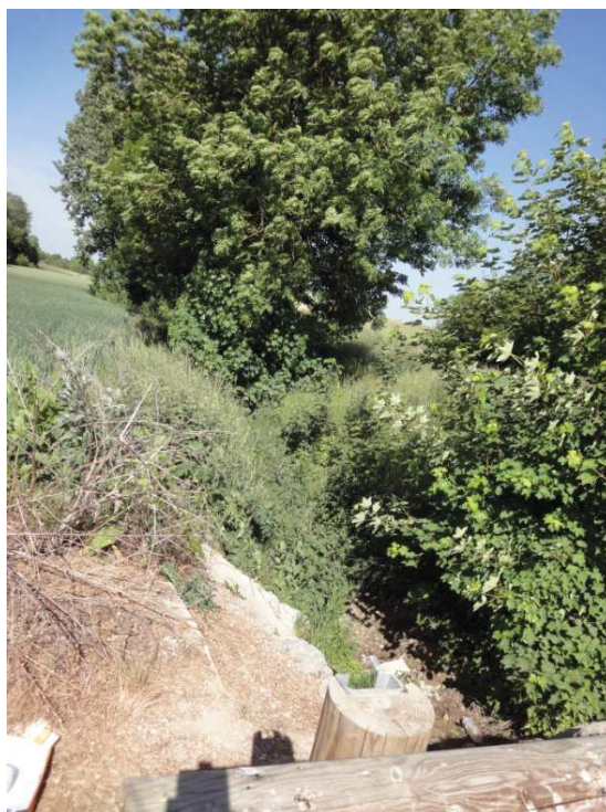
Fossé depuis le CR dit des bois
