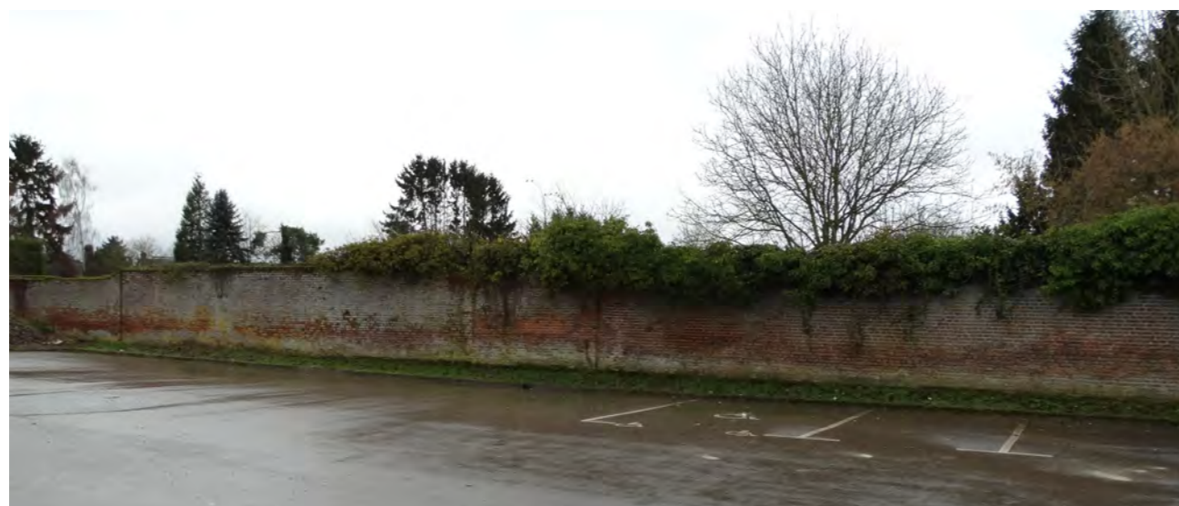
Murs de clôture en briques, ou pierres et briques, à conserver et valoriser
