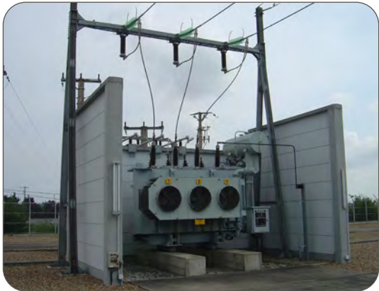
Exemple de transformateur 225 000/20 000 volts
