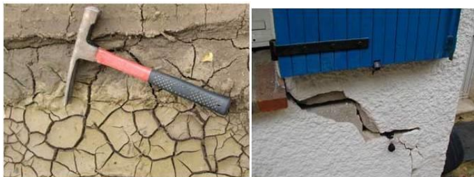
Représentation des dégâts liés au risque retrait/gonflement des argiles
