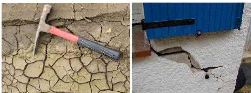
Figure 28 - Représentation des dégâts liés au risque retrait-gonflement des argiles
