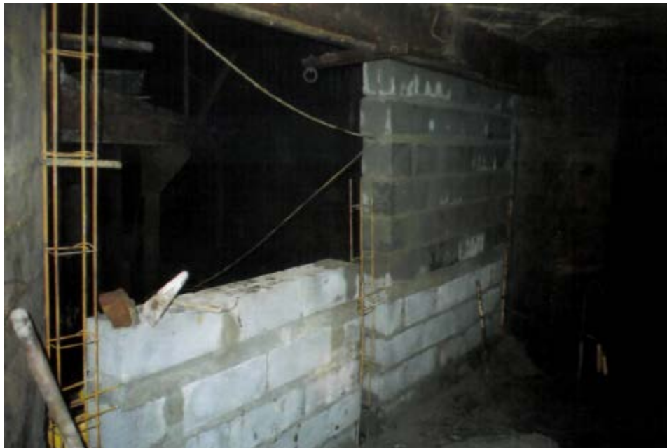
Photo 62 : Mise en place de murs étanches dans le tunnel du puits des Graves
