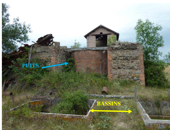
Photo 14 : Bassins de décantation et puits du Monteil
