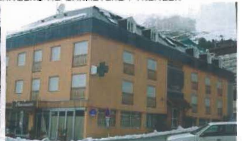
TEINTE D'ENDUIT TROP SOUTENUE
