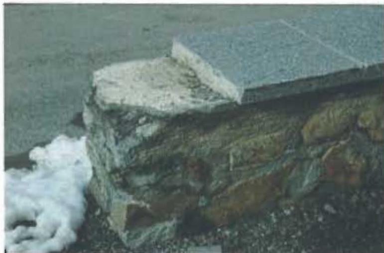
MATÉRIAUX VULNÉRABLES AU DÉNEIGEMENT
