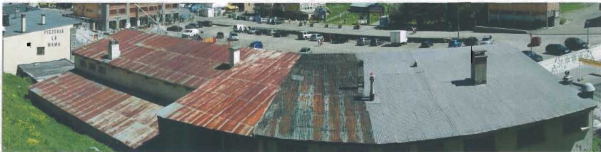
TOITURES À FAIBLE PENTE EN TOLE ONDULÉE DÉLABRÉES
