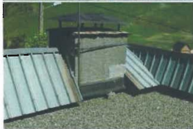
DÉTAILS D'OUVRAGES EN TOITURE NON TRAITÉS
