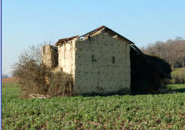
Bâti ancien abandonné (quartier Lantonies)
