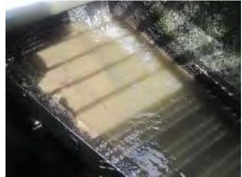
Canal de dessablage
