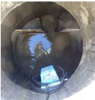
Figure 6 - Exemple de point de mesure de débit
