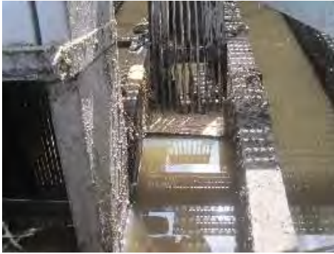
Grille de secours
