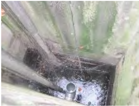
Poste de recirculation
