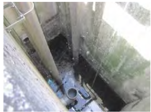
Poste de recirculation
