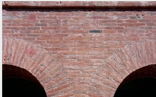
Arc plein d'ouverture
