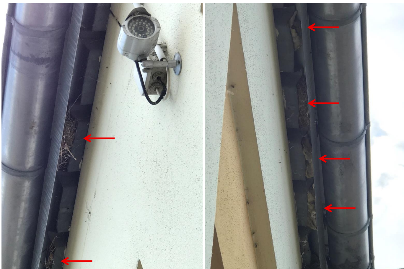
Figure 24 : Bourrage de nid effectués par les moineaux sur la façade Nord du bâtiment Est
