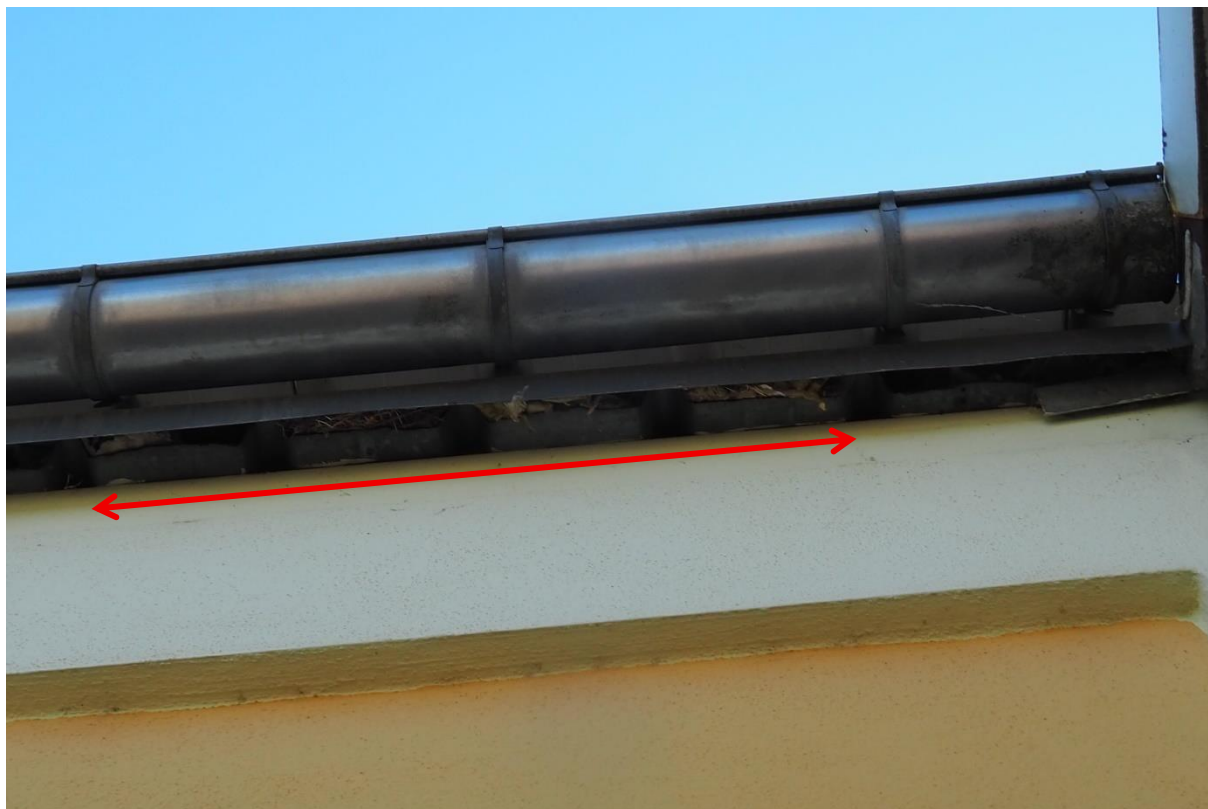
Figure 26 : Nids de moineaux domestiques sous les couvertines ou le double de la toiture
