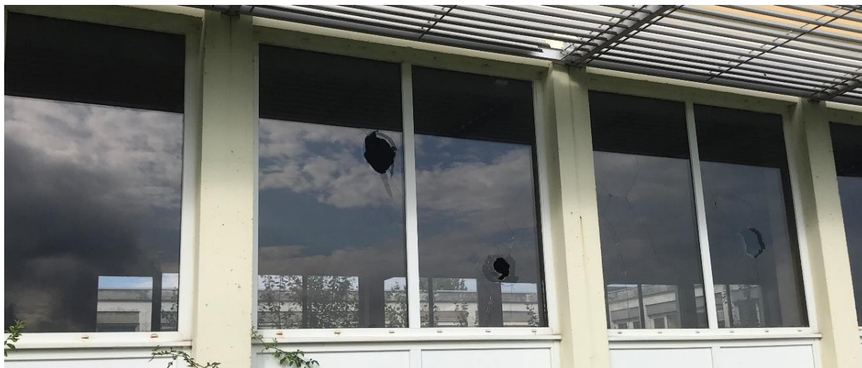
Figure 12 : Quelques fenêtres partiellement brisées
