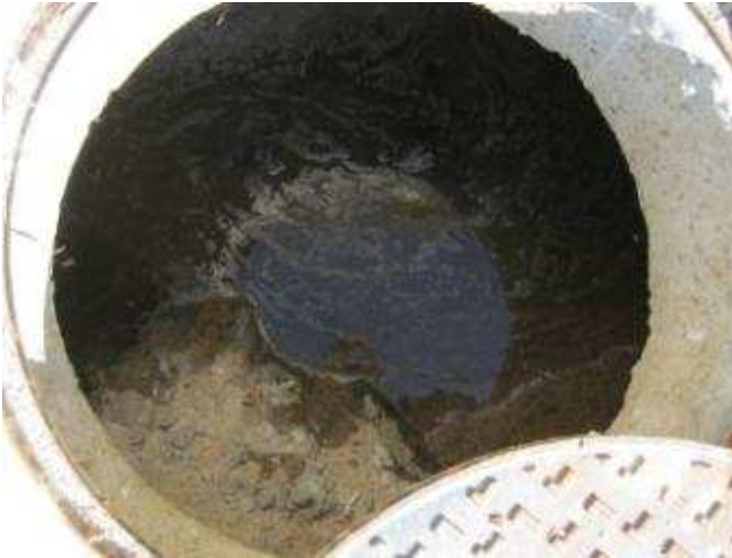
Collecteur en charge, absence de radier, dépôts et racines (Regard n°60, chemin rural n°9)
