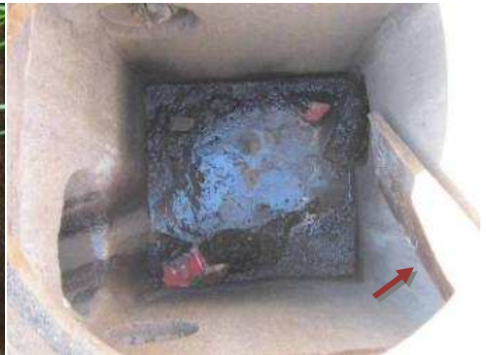
Dépôts, défaut génie civil (Regard n°42, en face caserne pompier)
