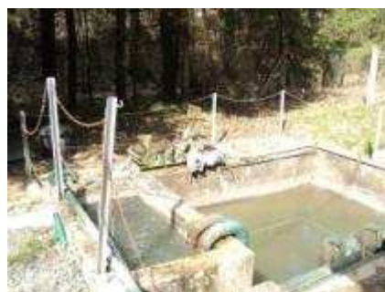
Dessablage / Poste de refoulement
