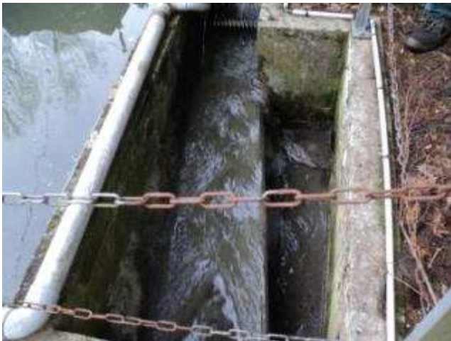
Déversoir d'orage en tête de station – Surverse par temps sec
