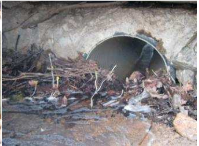
Collecteur partiellement obstrué, absence de radier, dépôts et racines (Regard n°60, agrandissement)
