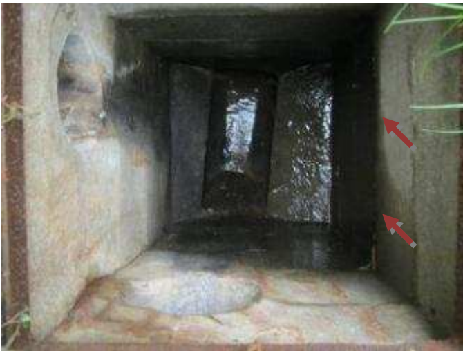
Infiltrations (Regard n°116 , en bordure de la Biconne)
