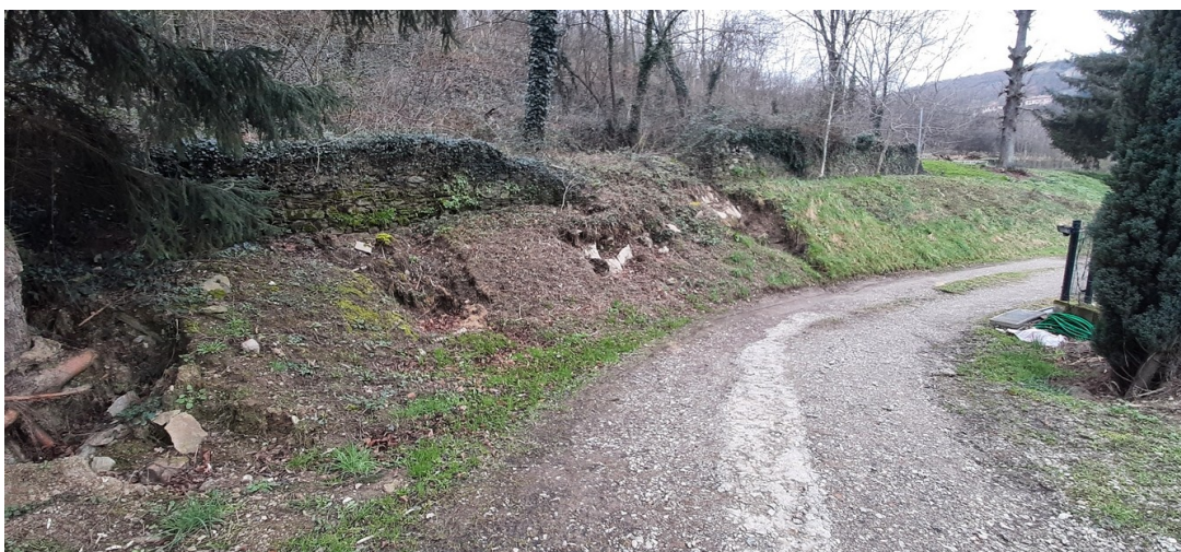
Figure III.5: Débordement du cours d'eau lors d'événements pluvieux intenses, lors du dernier événement le talus a été fortement érodé.
