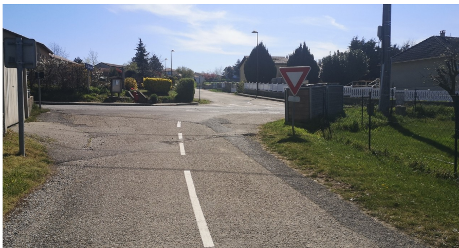
Figure III.4: Croisement entre la RD 103 et le chemin des Pierres Blanches. Les eaux de ruissellement peuvent suivre le chemin du brunet ou inondé la parcelle à droite.
