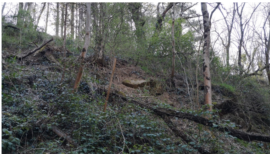
Figure III.7: Traces de glissement superficiel
