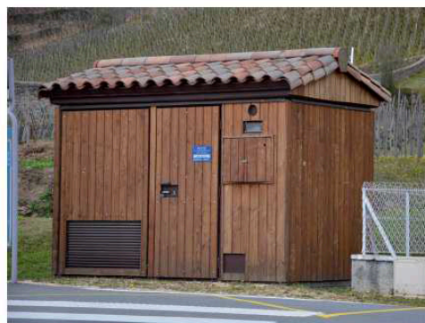
Exemple de local de transformateur électrique intégré
