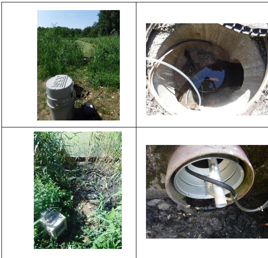
Point de mesure en entrée
