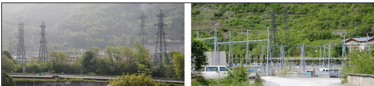
Photo 18 : Le poste EDF à l'entrée de Pomblière
