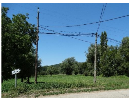
Réseaux aériens en surnombre
