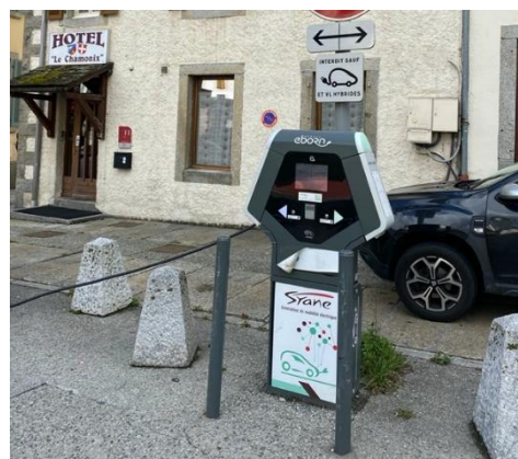
Borne de recharge électrique, derrière la mairie
