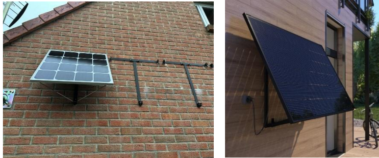
Exemple de panneaux solaires non parallèle à la façade
