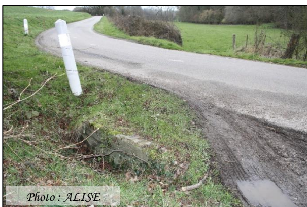
Photo n°1 Buse sous RD 90 colmatée à 100% (partie amont)
