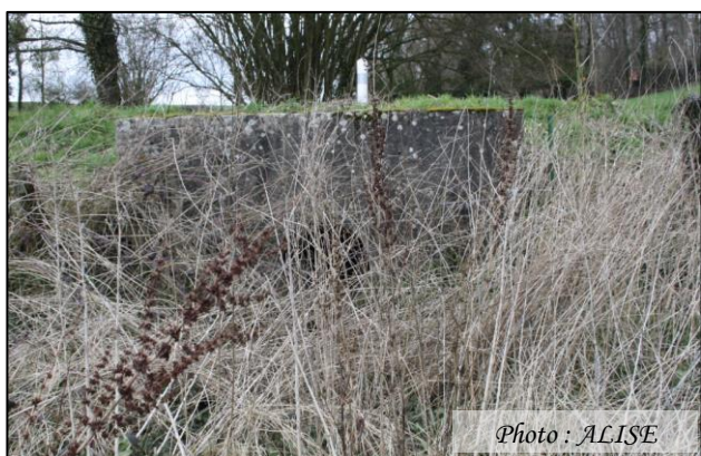
Photo n°2 Buse sous RD colmatée à 50% (partie aval)
