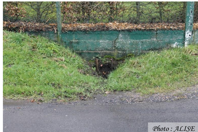
Photo n°31 Canalisation au point bas de la rue Verte
