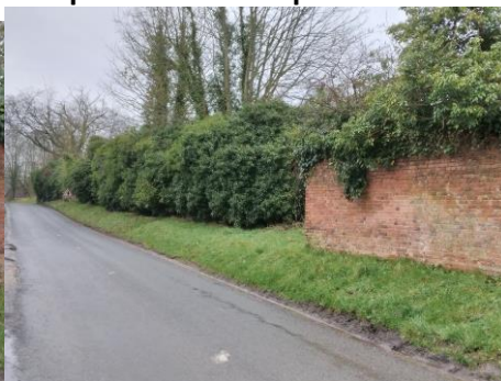
partie du mur le plus sain
