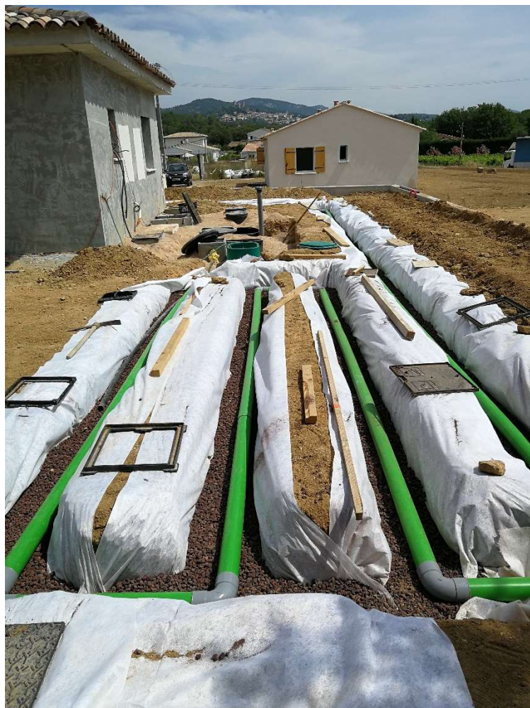
Installation d'assainissement non collectif
