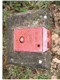
Bouche de lavage fermée
