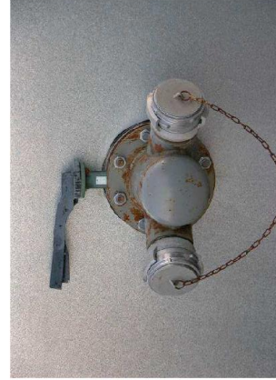
Prises directes de 100 mm sur réserve d'eau incendie aérienne
