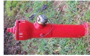
Poteau incendie de 80mm avec une sortie de 65mm
