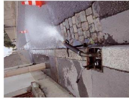
Bouche de lavage utilisée avec un « col de cygne »
