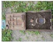
Bouche Incendie de 80 mm à tenons
