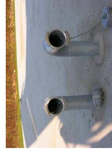
Deux colonnes d'aspiration de 100 mm sur une réserve d'eau enterrée
