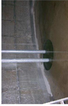
Fond de la cuve avec crépine sous le niveau le plus bas de l'eau
