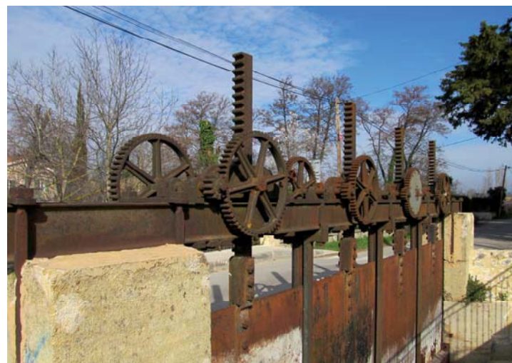
Système de vannes
