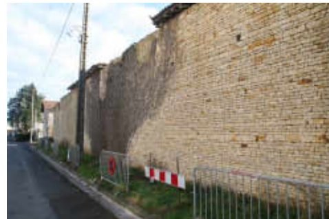
...prolongés par un bâti qui se dégrade.
