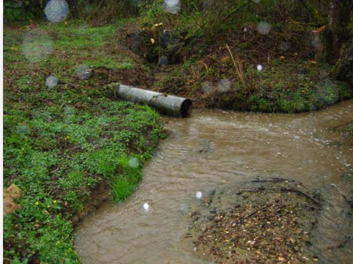
PHOTO 13 : POINT DE REJET DE LA STEP DU ROSEAU (DANS LE RUISSEAU "LE ROSEAU")
