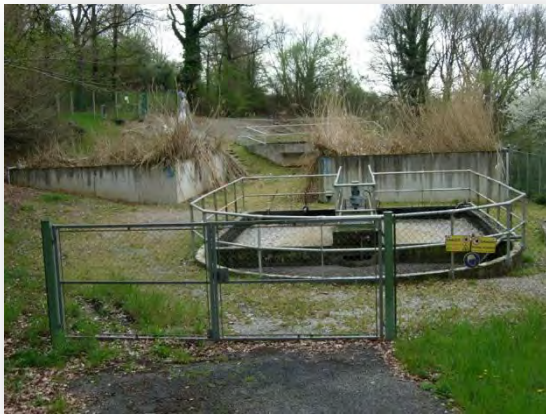
PHOTO 15 : STEP DE LA PLANCHE - BASSIN D'AERATION
