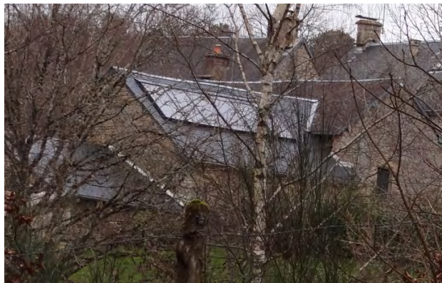
Panneaux solaires bien intégrés
