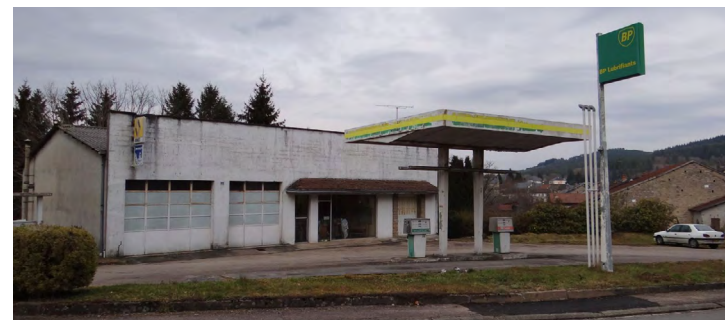
Le délabrement de cette ancienne station service dans le bourg affecte l'image du bourg
